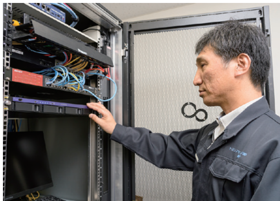
サーバー室の19インチラックに無駄なく収納
